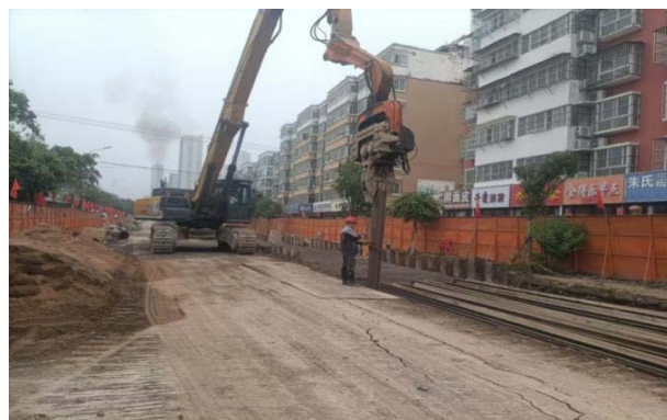
图2 钢板桩拔除造成基槽周边地面裂缝
