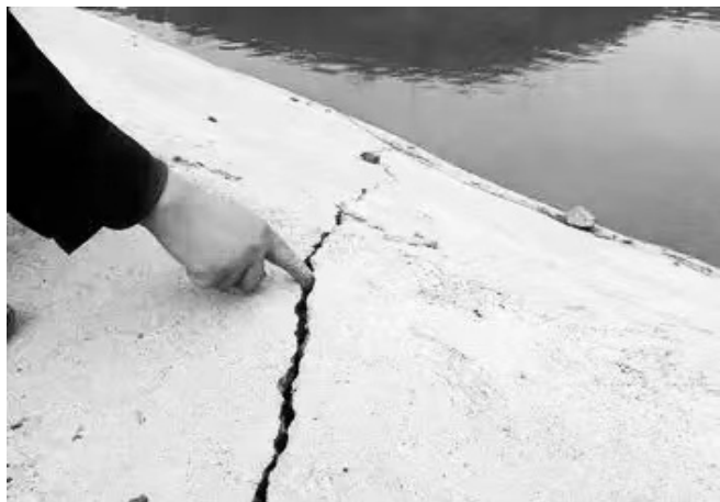
图1 某水库坝体裂缝
