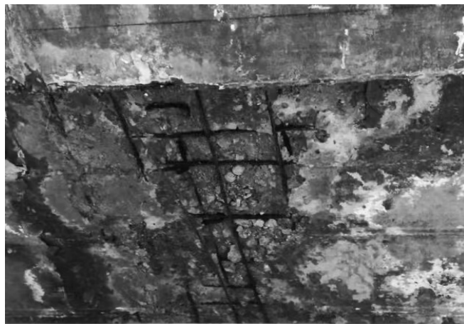
图2 某水利工程混凝土结构磨损
