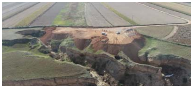
图为水利工程施工区的水土流失现状
