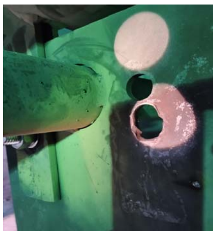
图二 均流板西侧上部吊板螺栓孔
