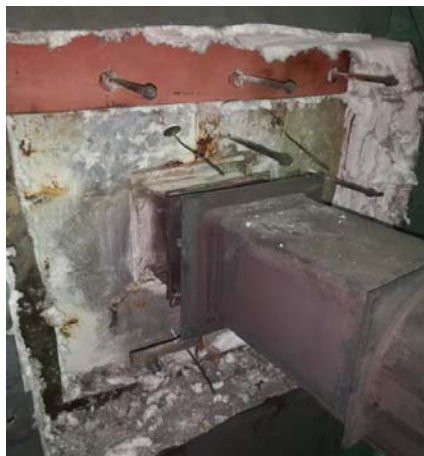
图一 均流板西侧底部支撑内护板撕裂
