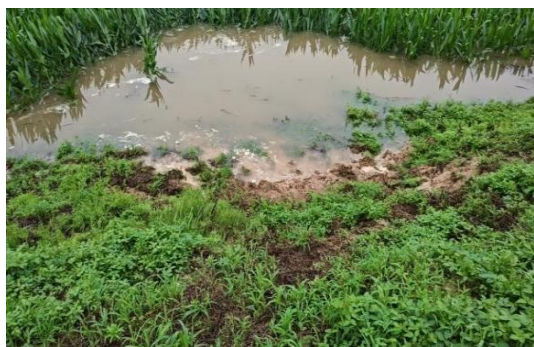
图1 脱坡险情原始现场
