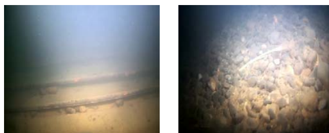
(a) 消力池底板顺河向钢筋裸露 (b) 消力池底板堆积物
